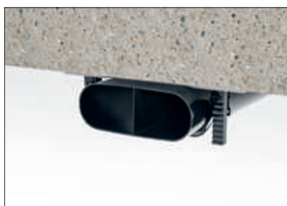
Canale piatto su solaio cantina
